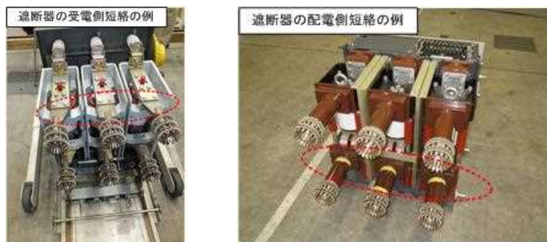
図 4-9 遮断器の短絡箇所 (M/C 試験時)
