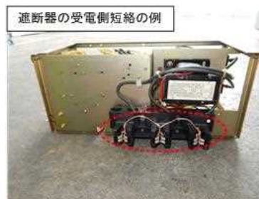
図 4-11 遮断器の短絡箇所 (MCC 試験時)
