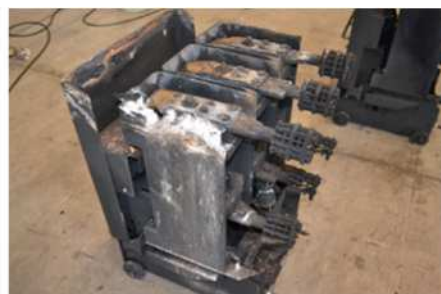
遮断器室アーク発生、アーク火災有、消火後の遮断器の様子
