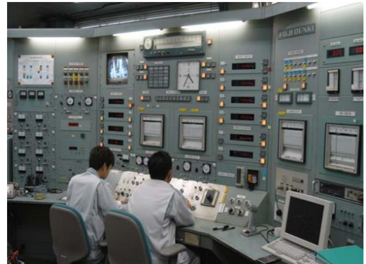
運転中の様子
