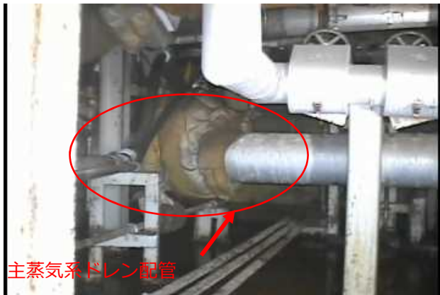
主蒸気系ドレン配管
