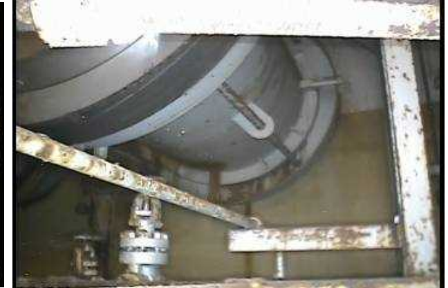
主蒸気配管 C
