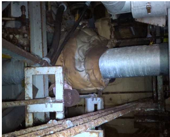
主蒸気系ドレン配管
