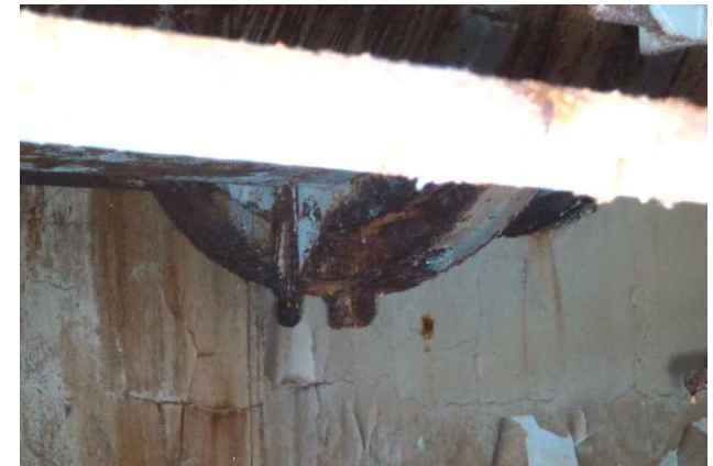
主蒸気配管 C
