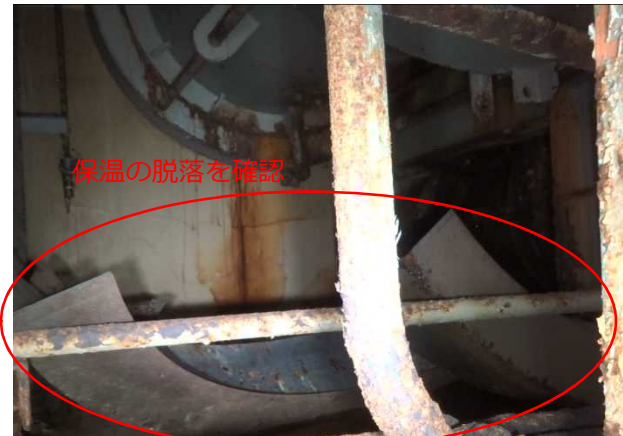
主蒸気配管 B
