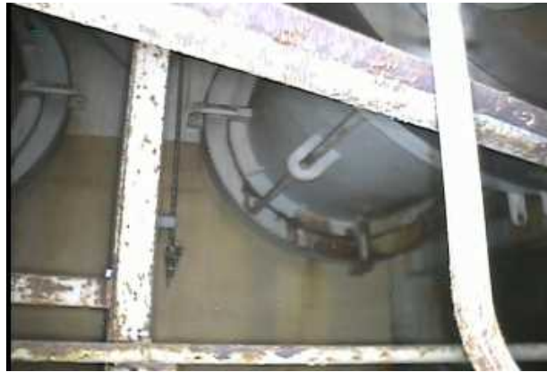
主蒸気配管 B
