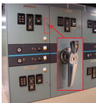
電源盤の施錠
