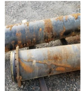
図 サリー原子力発電所で確認された消火水配管の破断状況
