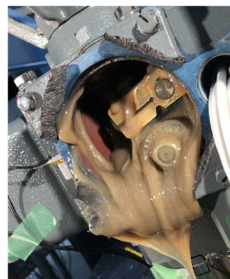
(c) モーター・フレーム損傷面
