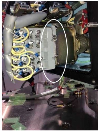
(a) フィンガーベースのひび割れ
