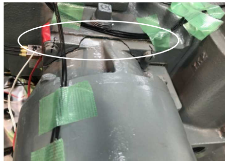
(a) モーター・フレーム上面のひび割れ
