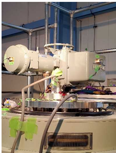
(a) 電気室側
