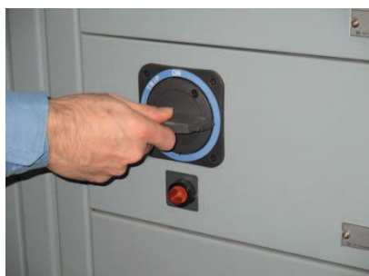
遮断器「切」操作
