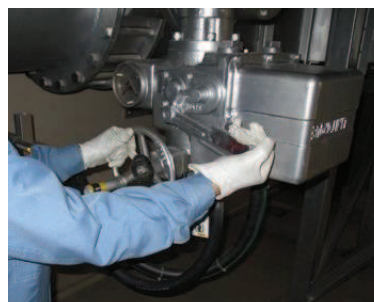
現場手動ハンドルによる開操作
