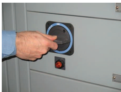
遮断器「切」操作
