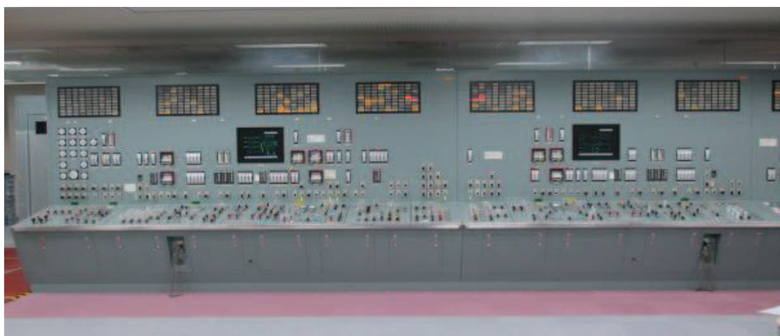
原子炉冷却制御盤
