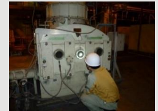
若手運転員の火力研修 巡視点検
