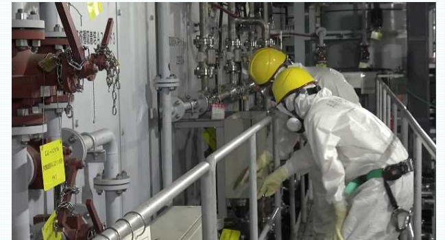
検査官によるALPS巡視の様子
