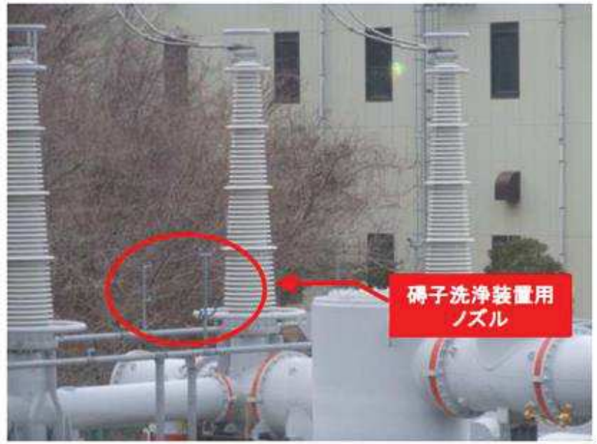
図 28 碍子洗浄装置外観
