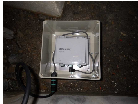
3号機に設置した地震計 (1階レベル)
