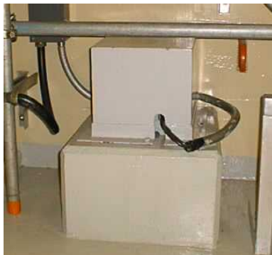
6号機の既設地震計
