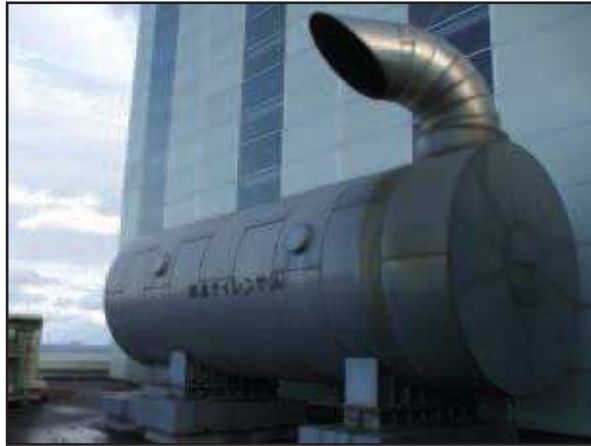
図1 ディーゼル発電機 排気管
