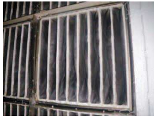
(バグフィルタ入口側)
