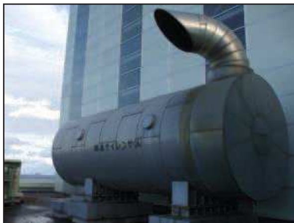
図 2.3-8 ディーゼル発電機 排気管
