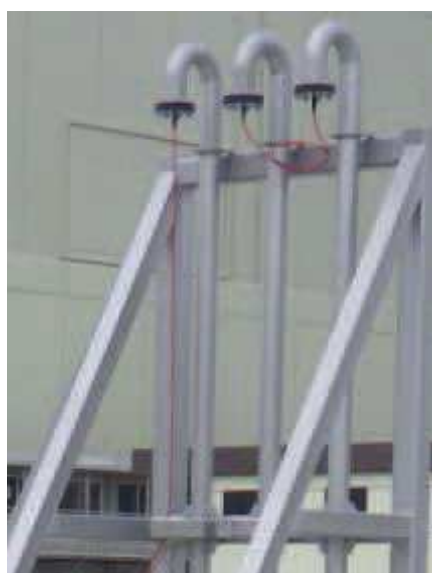
図 1.5-10 軽油タンクベント配管
