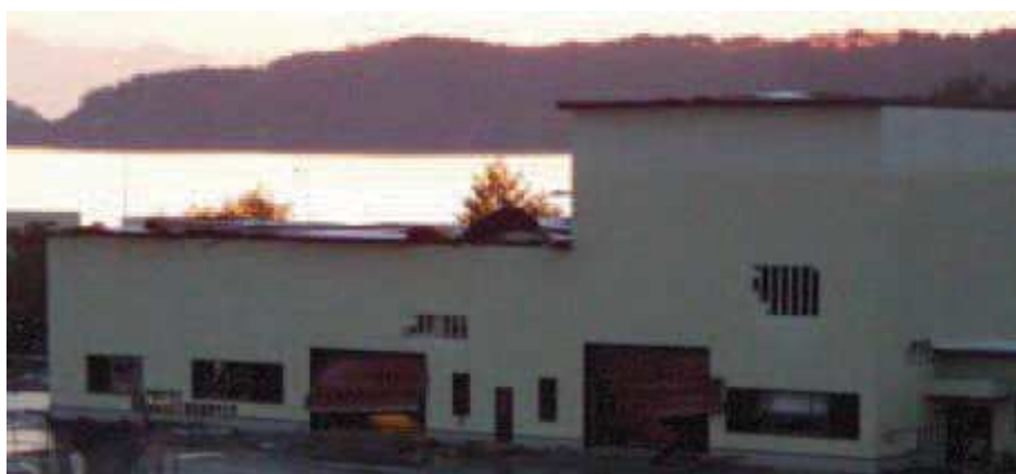
写真 4.2-1(1) 敷地内で確認された東北地方太平洋沖地震に伴う津波の漂流物（建屋壁材の剥がれ状況）
