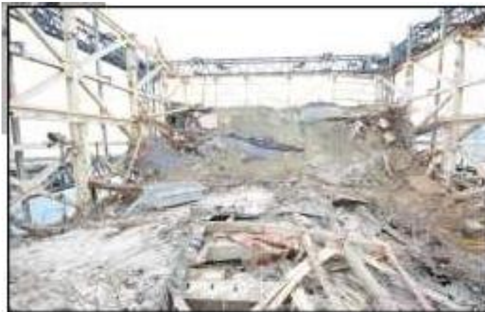
図6 1号機のオペフロの状況※
