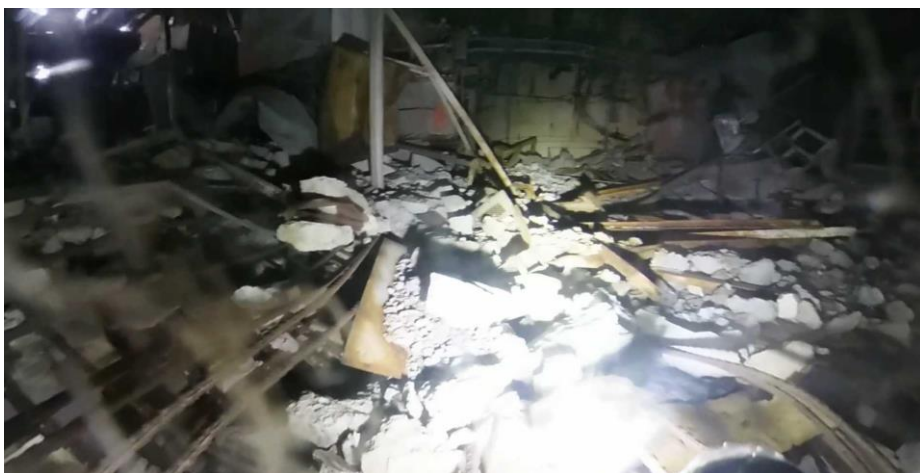
図5 4階床面のがれきの状況（図1の写真③）
