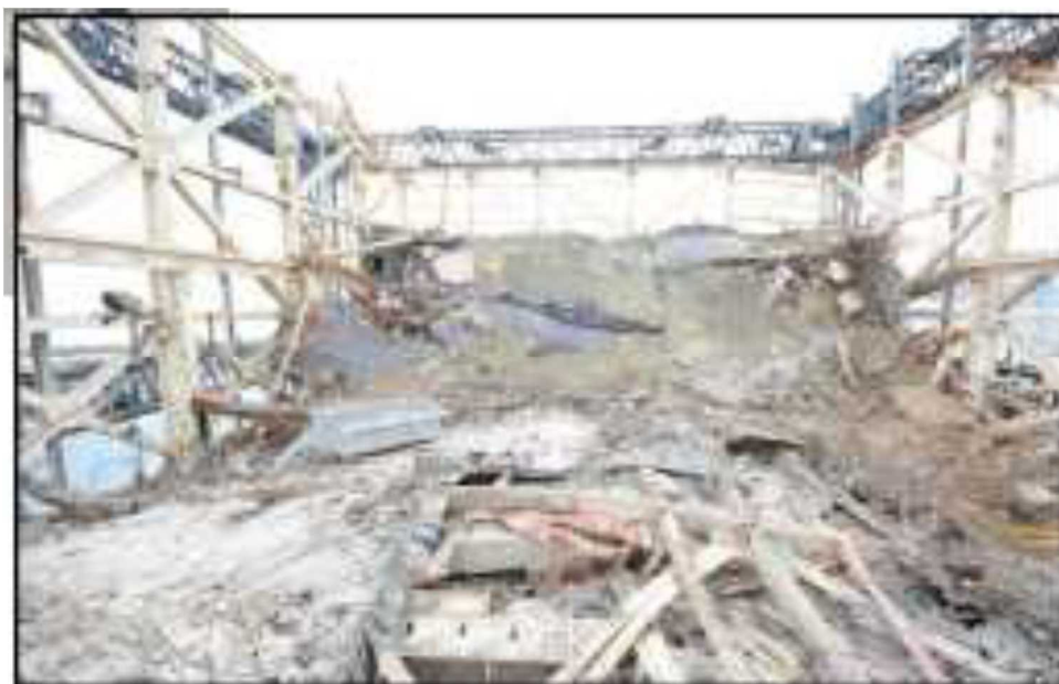
図6 1号機のオペフロの状況※
