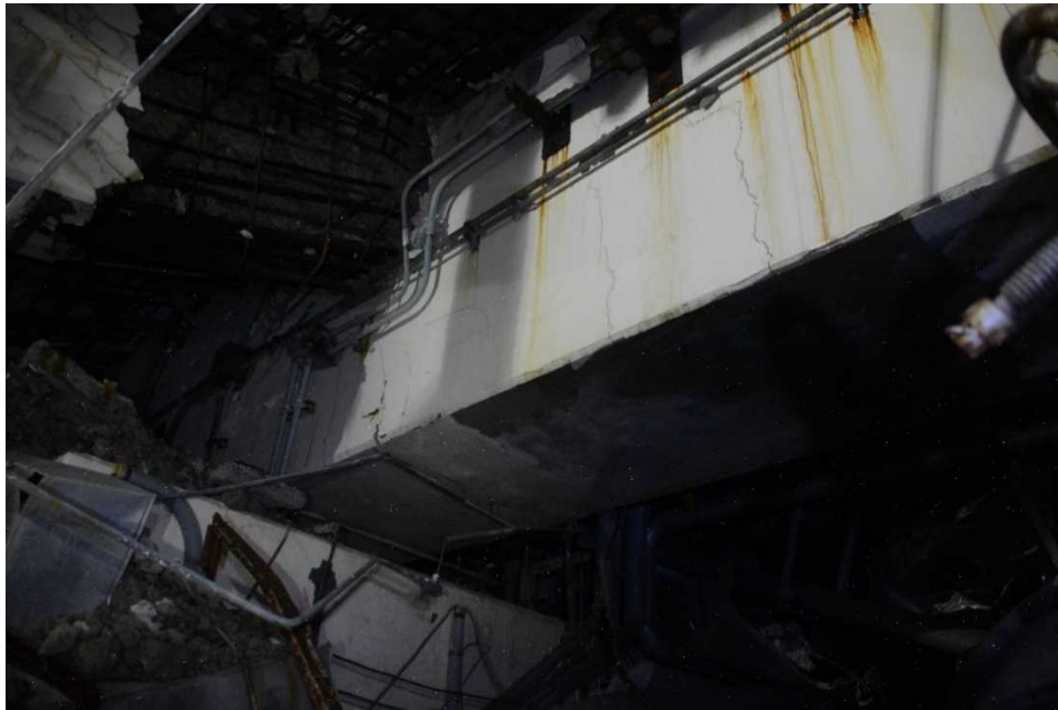
図 1 3 3号機原子炉建屋3階天井部の大梁(B)の損傷状況(2/2) (2020年9月の現地調査において確認されたもの)
