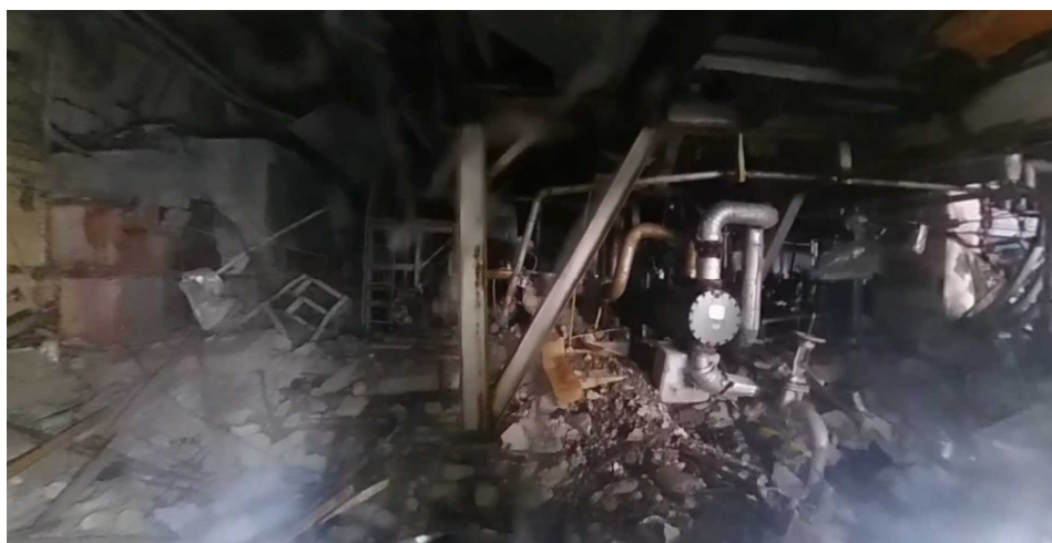
図3 4階に設置されている設備の状況（図1の写真②-1）
