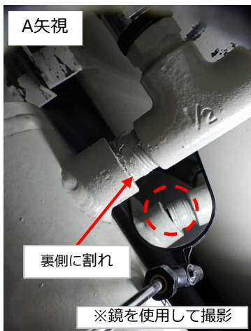
①損傷箇所（継手の付け根が割れ）
