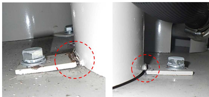
②損傷箇所（固定部割れ）
