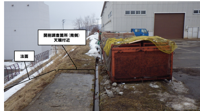
写真② 開削調査箇所(南側)付近法肩状況(平成25年3月撮影)
