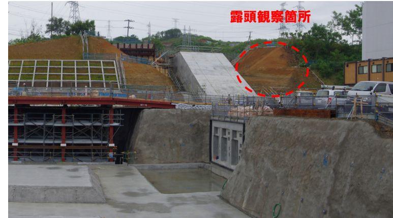
露頭全景(平成26年)
