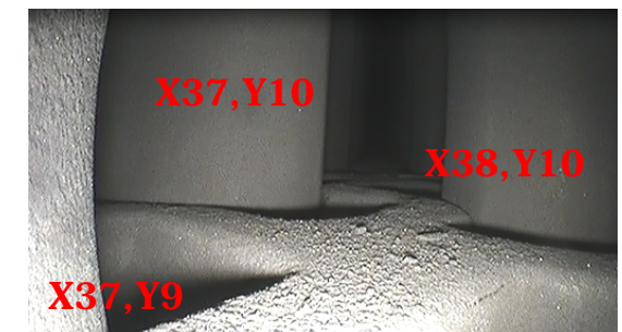
第二管支持板上
