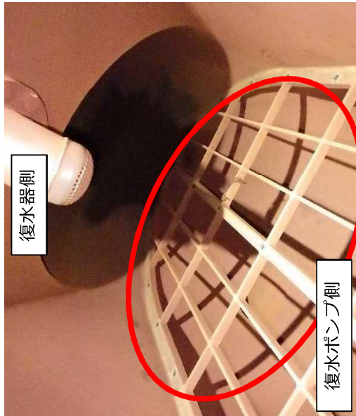
4A-復水ポンプ入口ストレーナ
