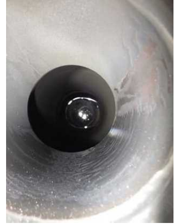
② 出口配管
