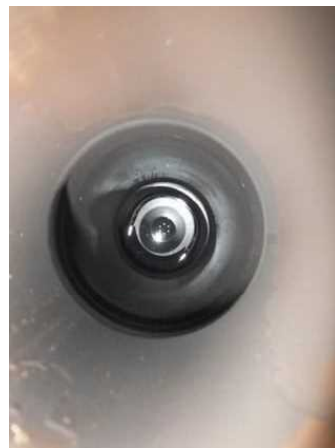
②出口配管
