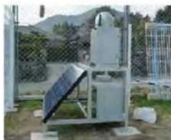
モニタリングポスト [25局] (ソーラ発電機装備)
