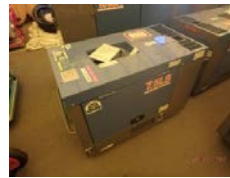
⑥可搬型発電機
