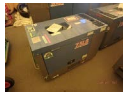
⑥可搬型発電機
