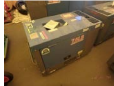
⑦可搬型発電機
