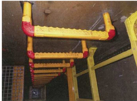
写真C 揚水井戸⑤(中段部) 2017/3/17撮影
