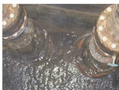
2号機揚水ポンプの例（揚水井戸⑥）
