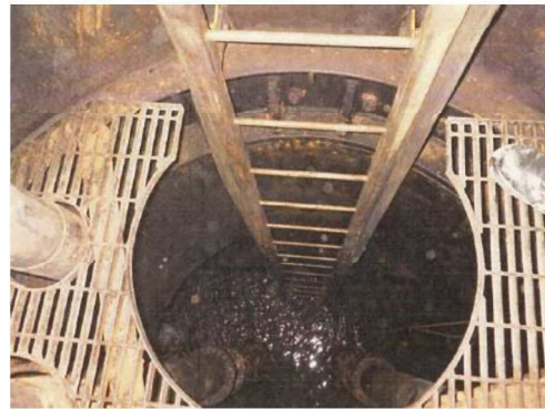
写真C 揚水井戸⑦(下段部) 2017/3/16撮影
