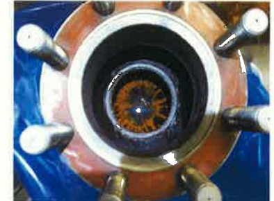
④ 水位制御弁内部
