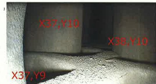
第二管支持板上
