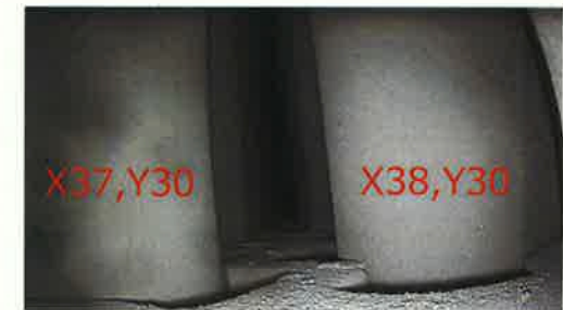
第二管支持板上
