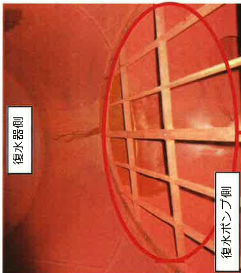
4 B - 復水ポンプ入口ストレーナ
