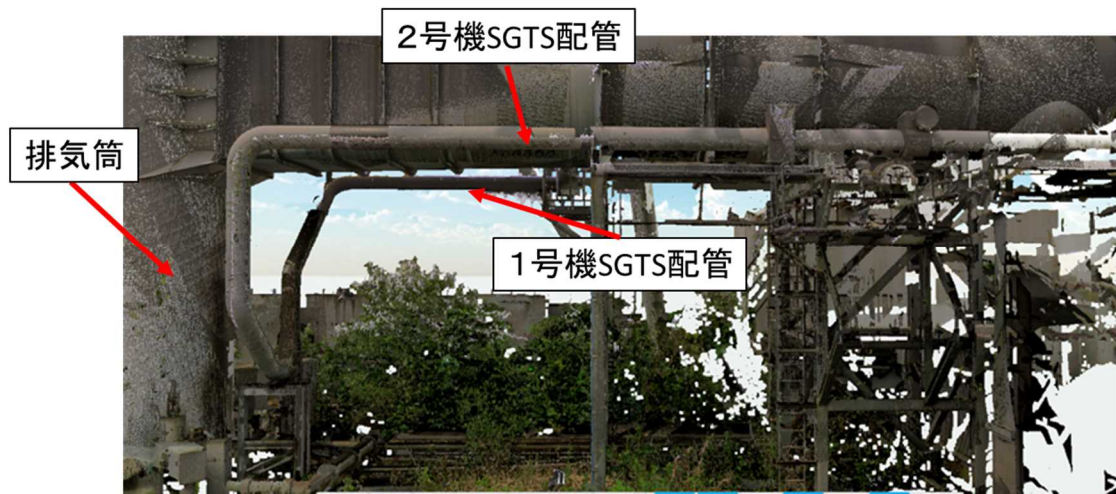
図8 測定結果（例）（1/2号機共用排気筒及びSGTS配管）
