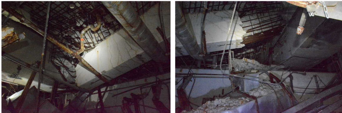
図2 3号機原子炉建屋3階天井部の小梁の損傷状況 (2019年12月の現地調査において確認されたもの)
