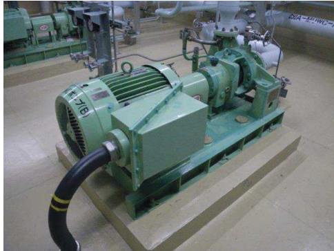
復水移送ポンプ
