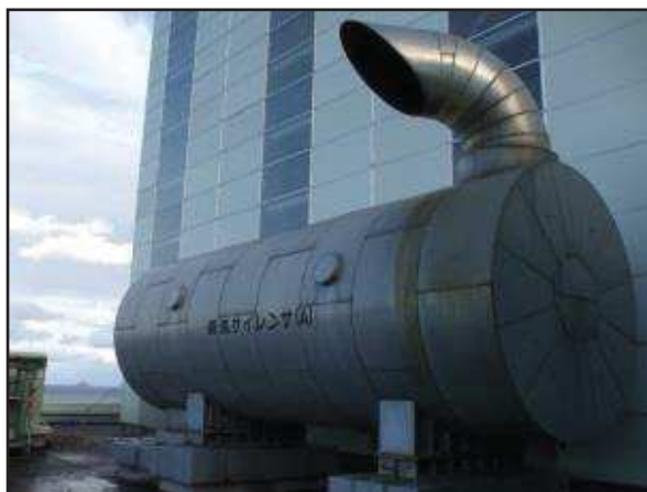
図1 ディーゼル発電機 排気管
