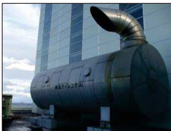
図 2.3-8 ディーゼル発電機 排気管
