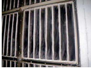
(バグフィルタ入口側)
