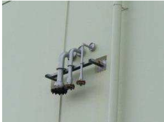
図 1.5-9 非常用ディーゼル発電設備付属ミスト配管
