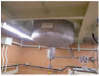
①洗浄液調整槽
