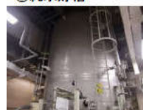
⑤純水貯槽
