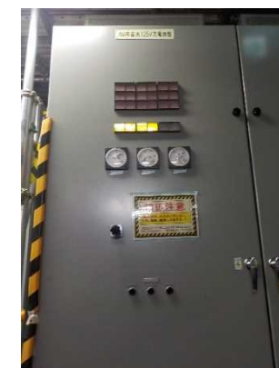
直流125V電源盤
