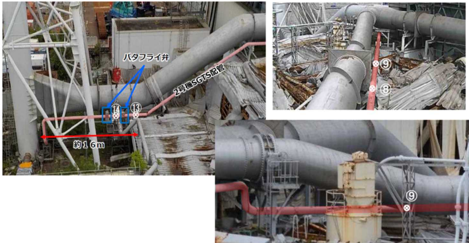
1/2号機SGTS配管撤去に向けた現場調査の実施状況について(2020年6月15日東京電力HD株式会社)より抜粋
