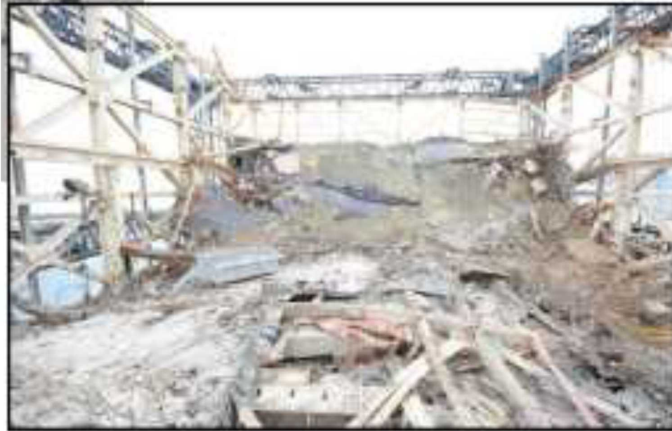
図 1号機のおペフロの状況※
