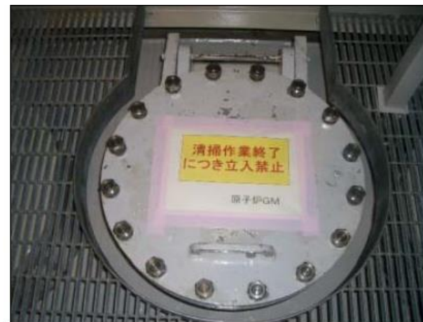
清掃後のD/W内マンホールの管理 (東電)
