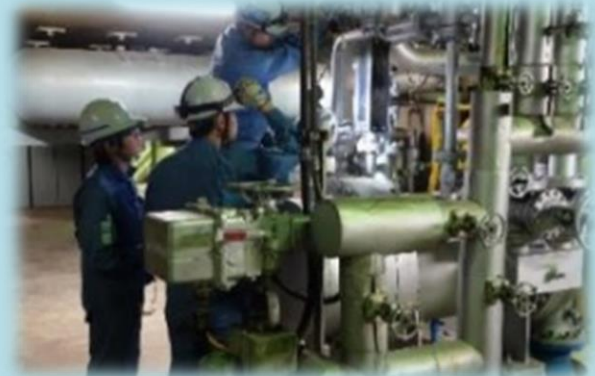
火力発電所、再稼働プラント、メーカー等への派遣 運転中火力発電所における研修
