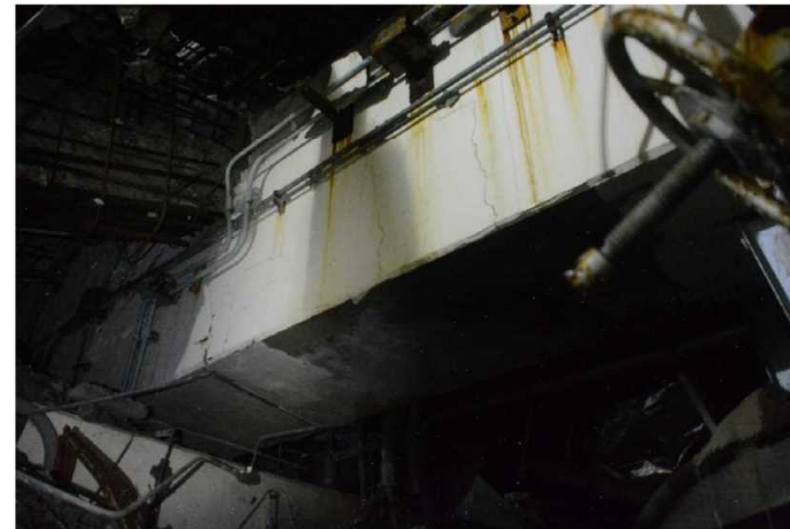
大梁Bの損傷 (No.7811)
