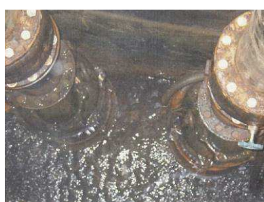
2号機揚水ポンプの例（揚水井戸⑥）
