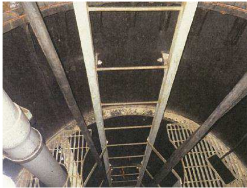
写真B 揚水井戸⑦(中間部) 2017/3/16撮影
