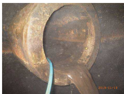
(a) 3号機海水熱交換器建屋山側
