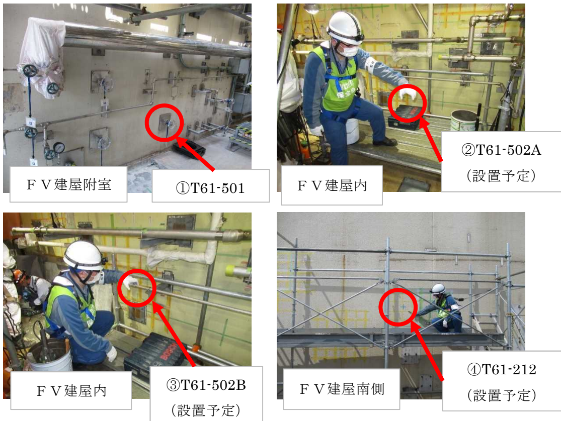
図2 操作バルブ写真
