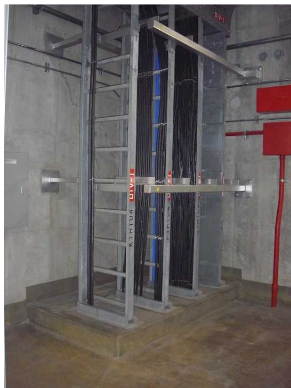
図2-1 ケーブルトレイ床貫通部外観
