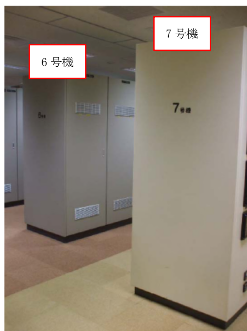
図2-26 制御盤（裏盤）の色別管理
