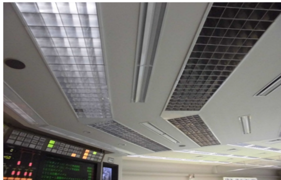
図 1-3 中央制御室照明
