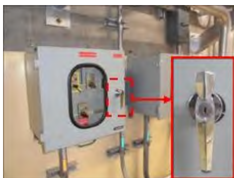
制御盤の施錠
