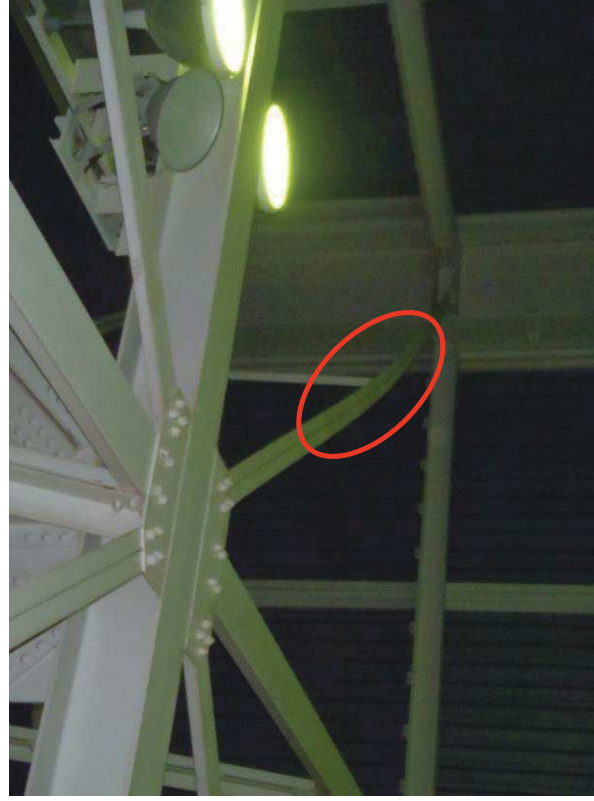
下弦水平ブレース(仮設部材) 160mm変形
