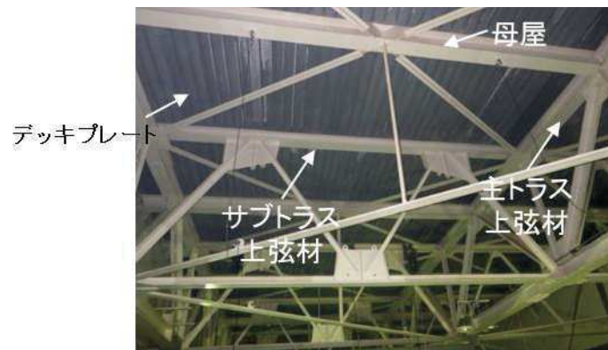
図 5.6-6 原子炉建屋原子炉棟天井の状況
