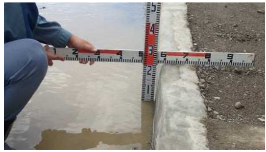
復旧前の段差状況
