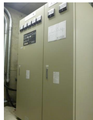
無停電電源装置の写真
