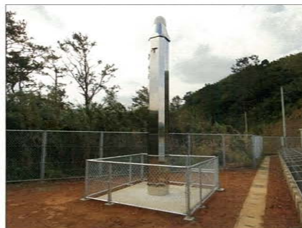
黒島の機器設置状況
