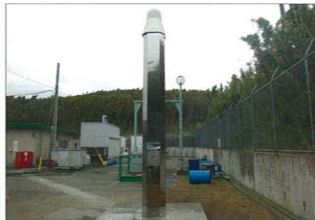
竹島の機器設置状況
