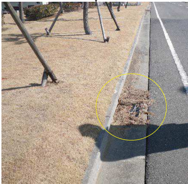
写真2 構内道路上に残留した塵芥
