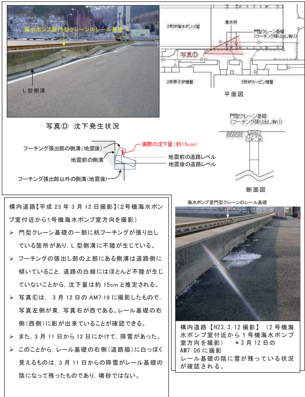
図 2-8 2011 年東北地方太平洋沖地震における沈下発生状況 (4 / 7)
