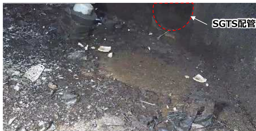
写真：SGTS配管状況（5/20雨天時）
